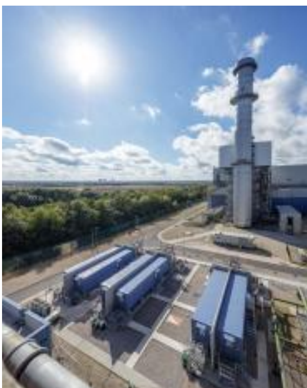
Figure 17 – Installation de stockage par batterie du site de la centrale de West Burton B au Royaume-Uni (EDF renouvelables) d'une puissance de 49 MW.
