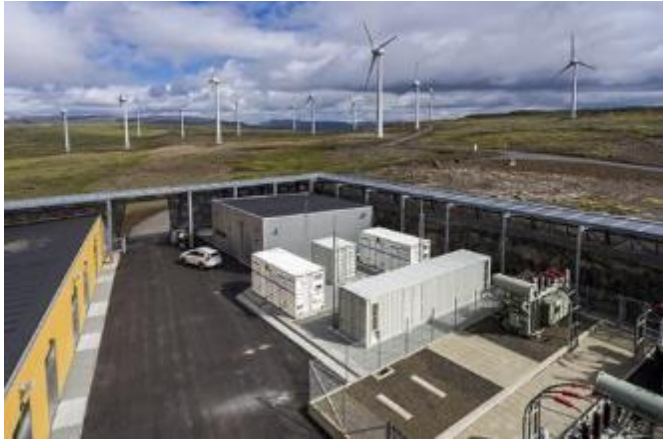
Figure 20 - SEV, la compagnie d'électricité des îles Féroé, a mis en service le premier système de stockage d'énergie Li-ion (ESS) entièrement commercial en Europe fonctionnant en combinaison avec un parc éolien. La solution de Saft, par conteneurs, contribue à maintenir la stabilité du réseau afin que les insulaires puissent exploiter pleinement le potentiel de leur nouveau parc éolien de 12 MW à Húsahagi.
