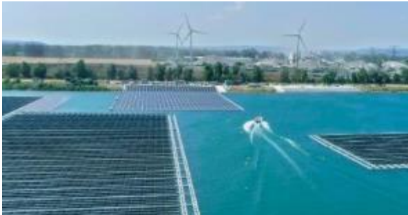
Figure 8 - O'MEGA1, plus grande centrale de solaire flottant d'Europe (flotteurs Hydrelia® by Ciel et Terre) à sa date de mise en service en 2019. Sa production annuelle permet d'alimenter en électricité plus de 4373 foyers.
